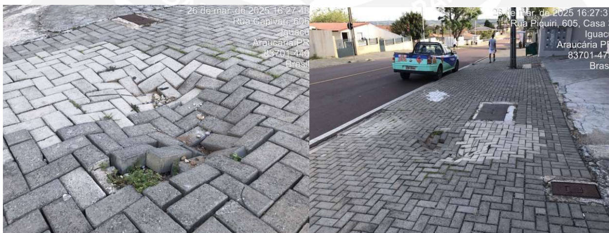
FIGURA 01 – Afundamento na calçada
